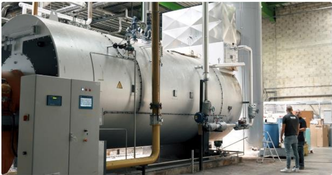
La chaudière de l'usine est désormais équipée d'un osmoseur.
