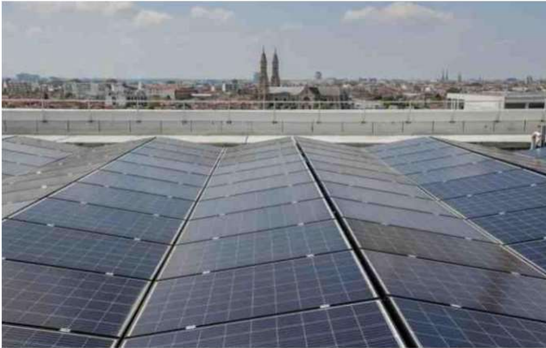
Les panneaux solaires de la toiture du nouveau siège de la Caisse des dépôts, dans le quartier d'Euratlantique. - GUILLAUME BONNAUD / SO
