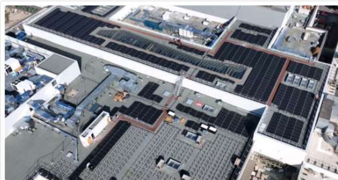
Plus de 1 700 m 2 de panneaux solaires ont été posés sur le toit de la nouvelle extension du centre commercial Grand'Place, à Grenoble. © Léon Grosse Énergies renouvelables
